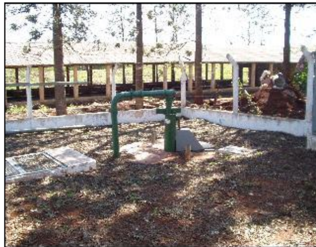
Figura 8. Foto do poço tubular profundo nº 02 / Paiçandu.
