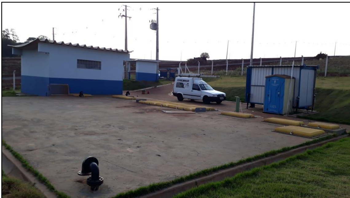
Figura 22. Elevatória 2 de Esgoto.
