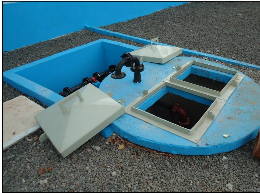
Figura 21. Elevatória 1 de Esgoto.
