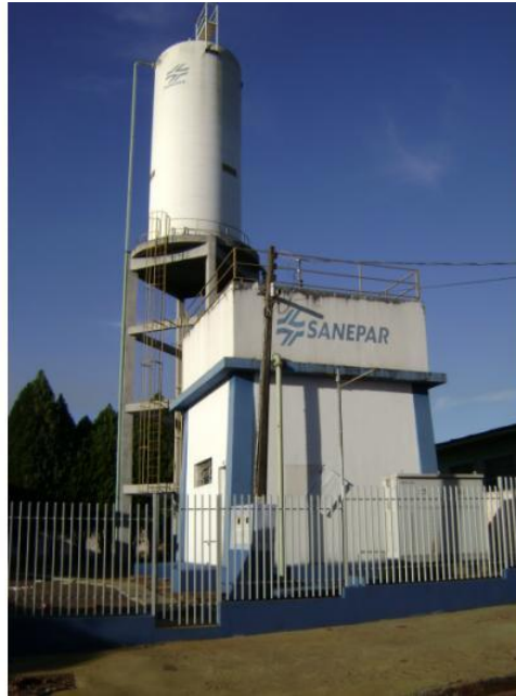
Figura 20 . Reservatório Elevado – 02 (100 m 3 ) / Água Boa.
