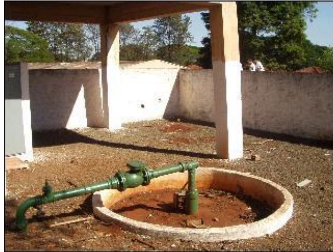
Figura 7. Foto do poço tubular profundo nº 01 / Paiçandu.
