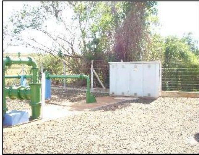
Figura 9. Foto do poço tubular profundo nº03 / Paiçandu.
