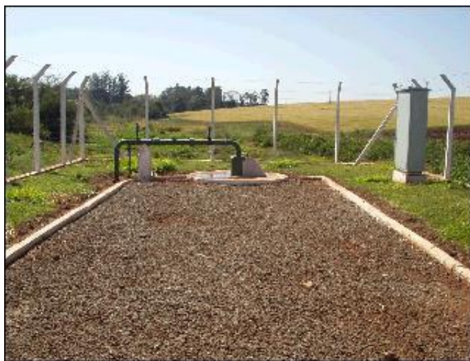
Figura 11. Foto do poço tubular profundo nº05 / Paiçandu.
