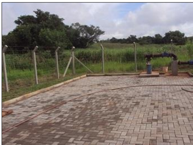
Figura 13. - Foto do poço tubular profundo nº07/ Paiçandu
