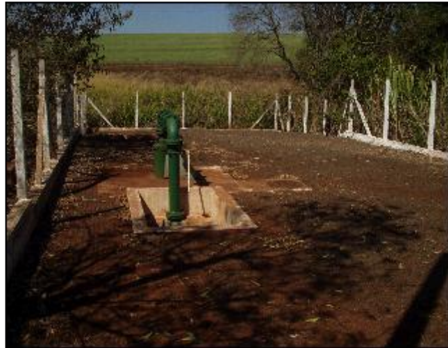
Figura 10 . Foto do poço tubular profundo nº04/ Paiçandu.
